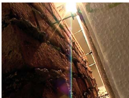
Krok 21 Celkový pohled na rubovou stranu zdiva. Detailní pohled na rozmístění zabudovaných kotev a vzduchovou mezeru. Kotvení zdiva zajistí jeho stabilitu.
