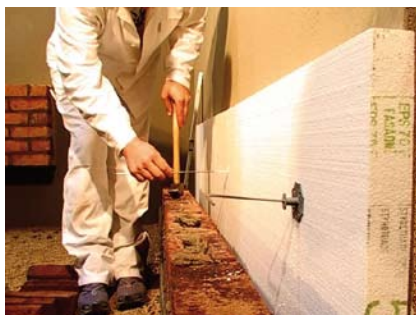
Krok 17 Ohnutý konec trnu vtlačíme do čerstvě nanesené zdíci malty v ložné spáře.
